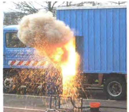
Projection de matière en fusion lors d'un court-circuit
